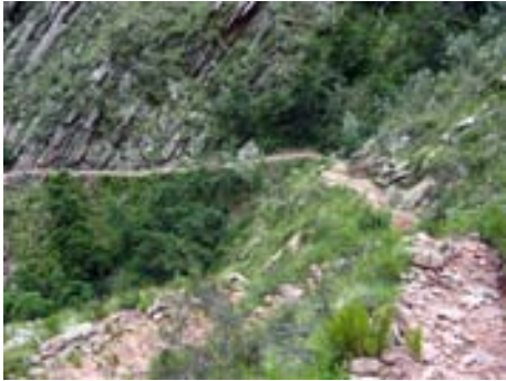
Fig. 15. Presencia de escombros sobre plataforma, producida por cauces de agua de lluvia.
