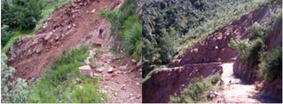
Fig. 14 A y B. Pequeño derrumbe que se llevó el camino.
